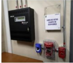
SEGURIDAD FÍSICA CENTRO DE DATOS e IDF's
